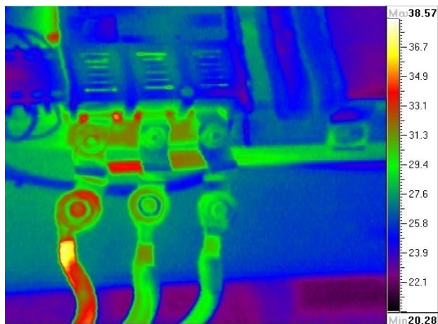
Рисунок 21. Пример термограммы контактных соединений с температурной шкалой
