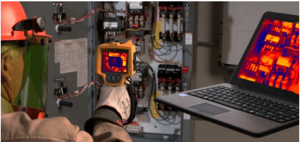
Рисунок 20. Пример проведения тепловизионного контроля электрошкафа
